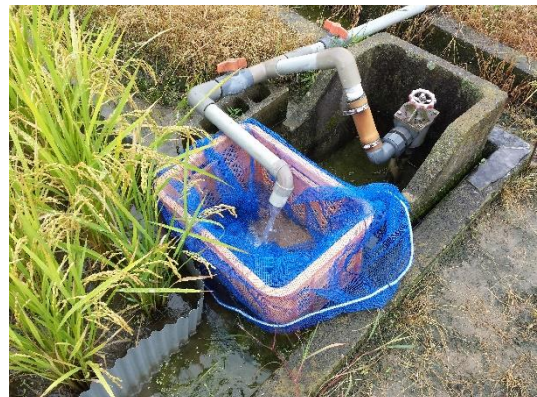
取水口に設置した侵入防止資材の例
